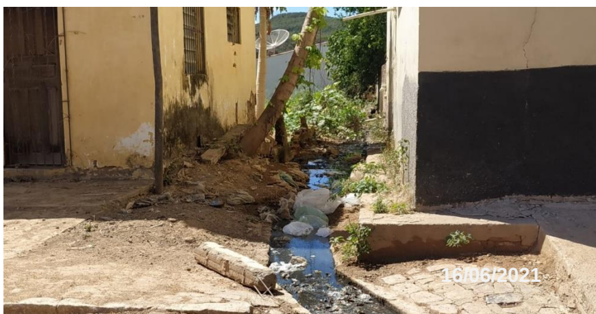
Foto 01 – Esgoto a céu aberto no município. (Área 01) – 16/06/2021
